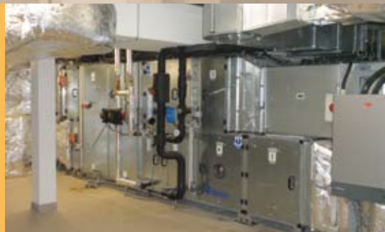
Nová strojovna vzduchotechniky
